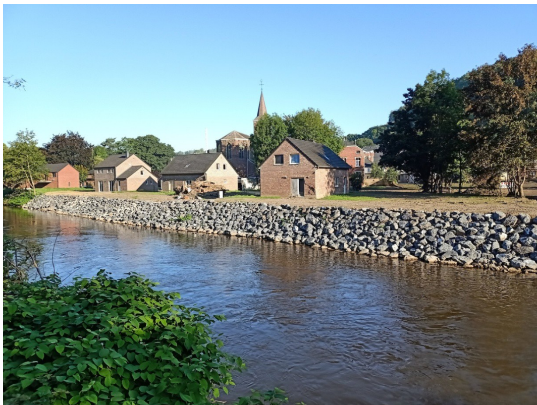
Nouveaux enrochements sur la Vesdre.
